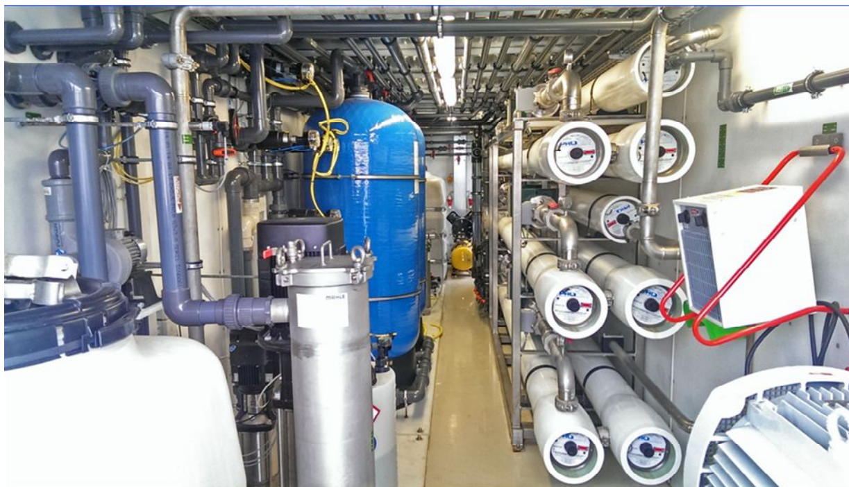
Рис. 6 - Внешний вид контейнерной установки обратного осмоса по очистке фильтрата полигона
